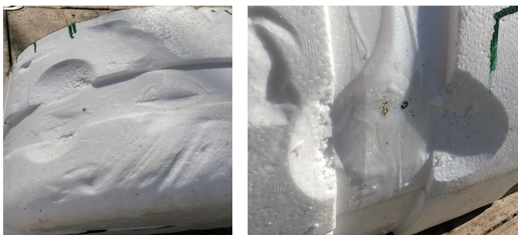
図 3.29 焼津港に持ち帰り状態確認を行った際に EVフロートとの接触面の変形が見つかった
