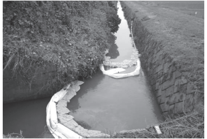
写真3 鮫鯨樋門に設置されたオイルフェンス（10月24日）
