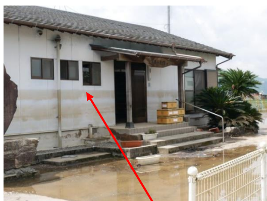
写真 5 外壁にのこる油水の跡
