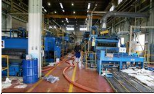
写真 4 佐賀鉄工所建屋内部 青色の機械が焼き入れ装置で、その下に焼き入れ用の油槽が設置されている。
