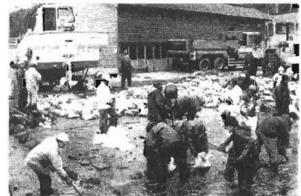
土嚢袋に油を入れている状況
