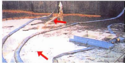
東扇島の船溜りへ流入した漂着油防除のためエンドレスロープ(矢印)を設置 油導入式浮枠をユニックで投入後2名で展張と追い込み回収した (ダイヤモンド・グレイス号 計1,500m)
