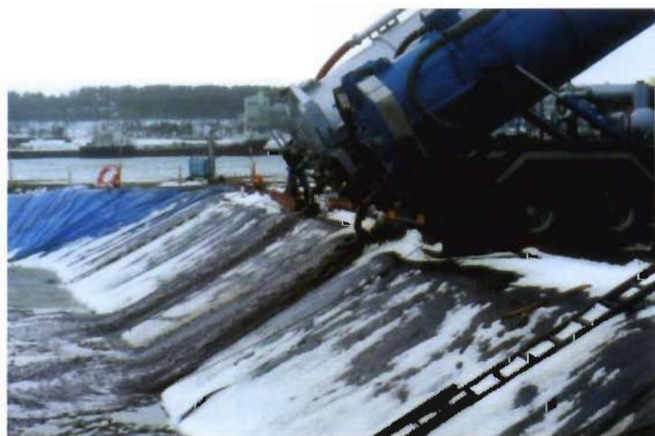
写真19 ピット・・ナホトカ 大量の回収油を收容するため、現場近く福井港の空き地に掘 削と土盛りにより緊急に作られたピット、容量2,700立方 メートル。強力吸引車で回収油を投入、3日でほぼ一杯に なった。
