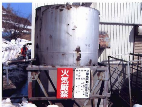
ボイラー用タンク
