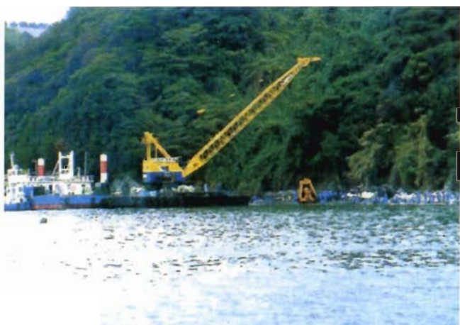
写真 12 グラブ船 喫水が浅いため、アームを延ばし辺鄙な海岸の漂着油の回収が容易
