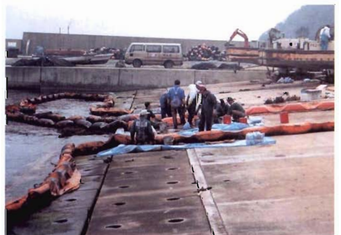
写真9 破損したOF修理
