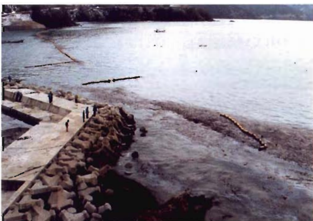
写真8 荒天の後、破損したOF
