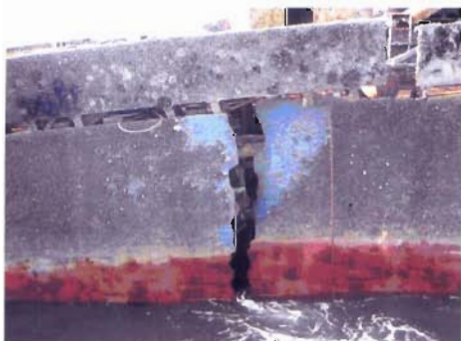
写真 14. 船体への亀裂
