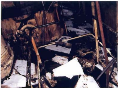
写真9. 機関室内の油の状況
