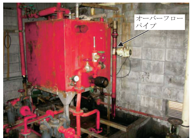
写真2 サービスタンクとオーバーフローパイプ
