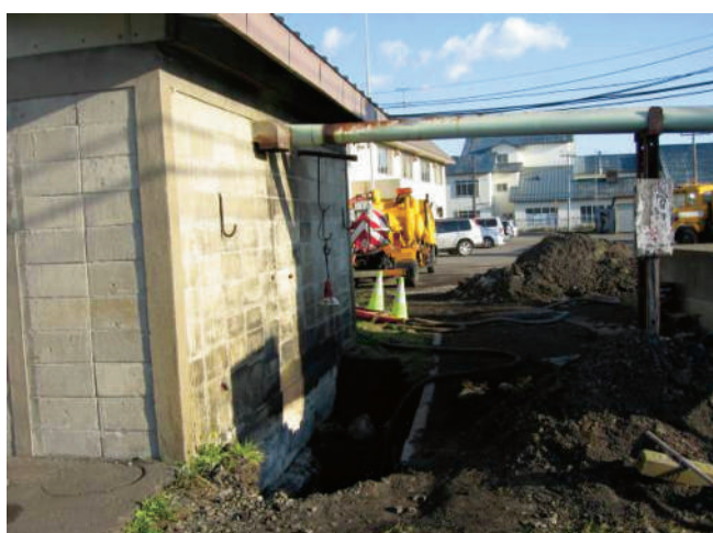
写真5 サービスタンク小屋と油漏洩部掘削
