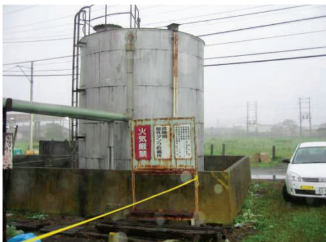
写真1 外部タンク 30kl、
