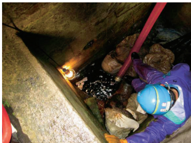
写真4 雨水枡、油が地下水と一緒に出てくる
