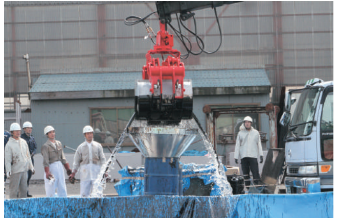
サイドから水と油が吹き出た
