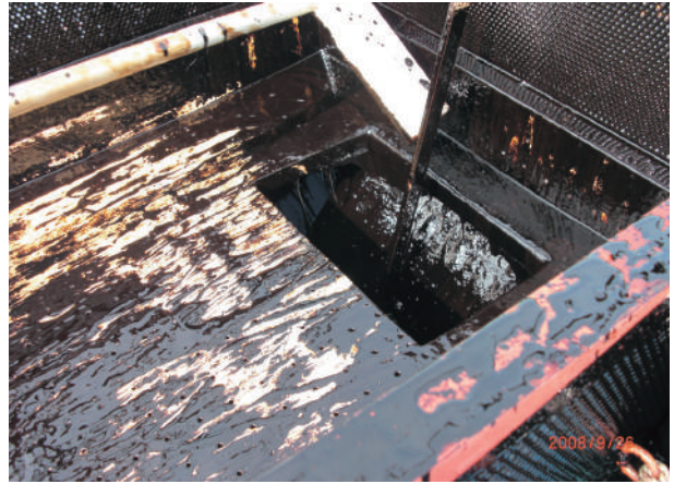
油のかき出しと排出口
