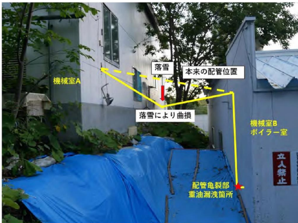
写真2 ブルーシートで養生された重油漏洩現場
