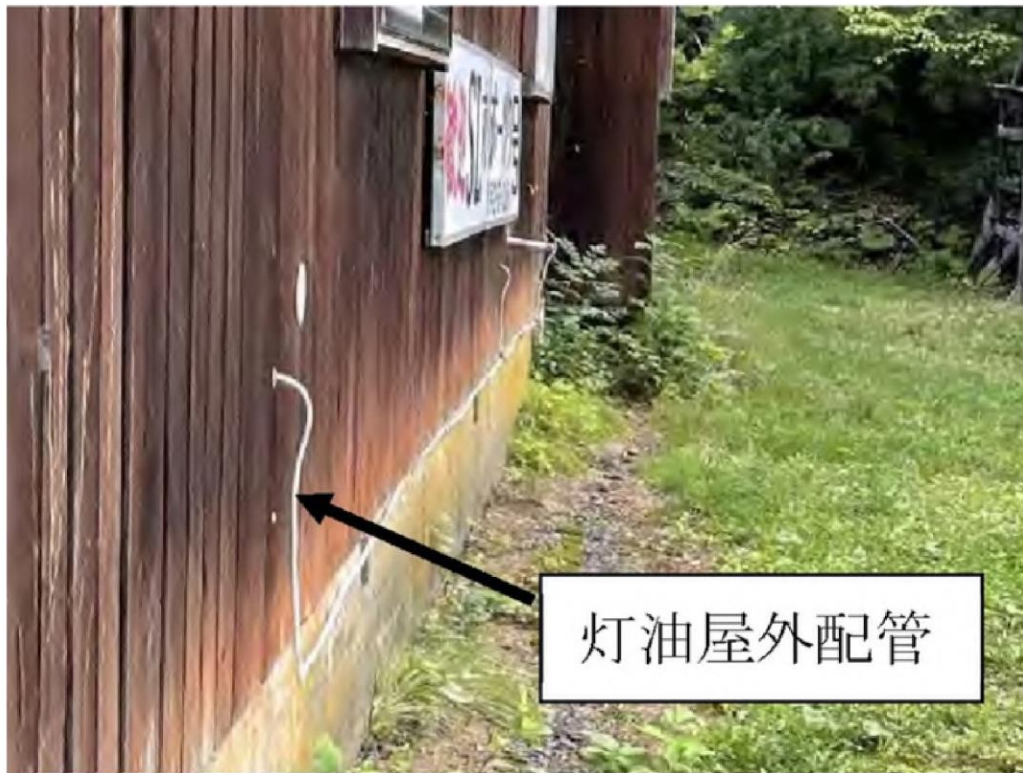
写真7 網走市内で見かけた灯油屋外配管
