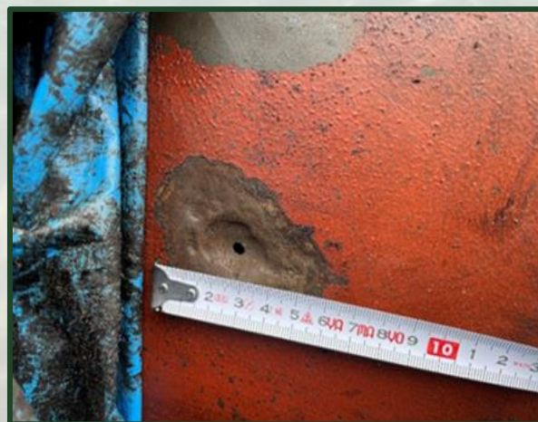
図11 検査の後、掘り起こしたタンクは穴があり油が漏洩していた。
