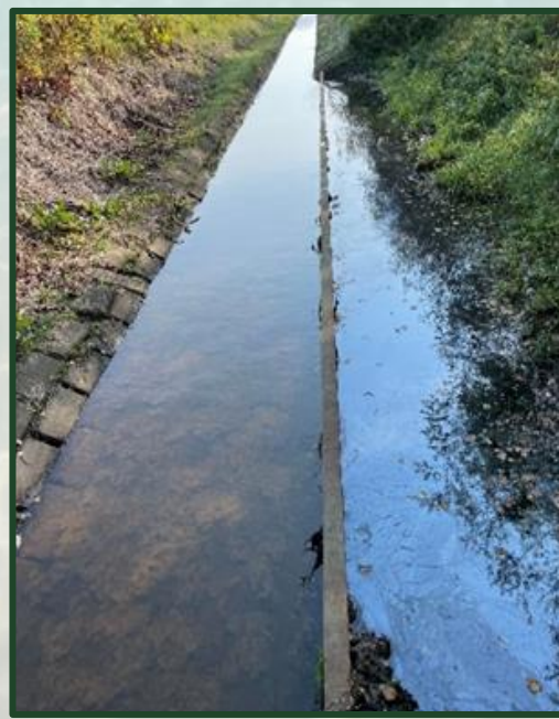
図13 同一か所 (R6.10.27) これは酸化被膜で油ではな い。
